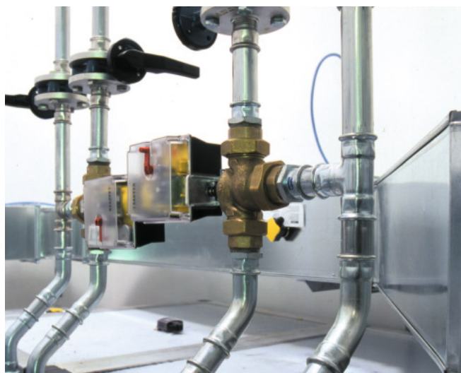
Bild 22 - steelPRES - Kühlwasser (geschlossene)
