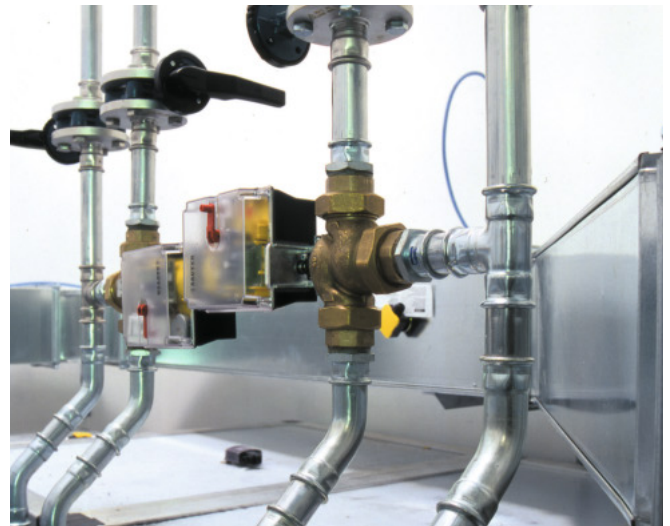
Image 22 - steelPRES - Eaux réfrigérées
